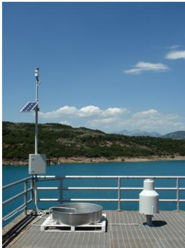
Σταθμός λίμνης Κρεμαστών
